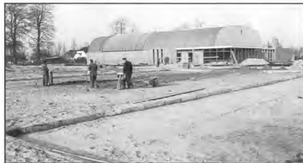
Foto 10. De bouw van de sporthal in 1969 in de wijk Weltevreden. Links een aantal beuken. Van de eiken achter de hooischaar is nog net de kruin te zien die boven de sporthal uitsteekt.
